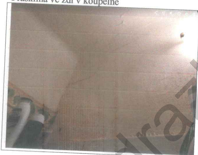
Prasklina ve zdi v koupelně
